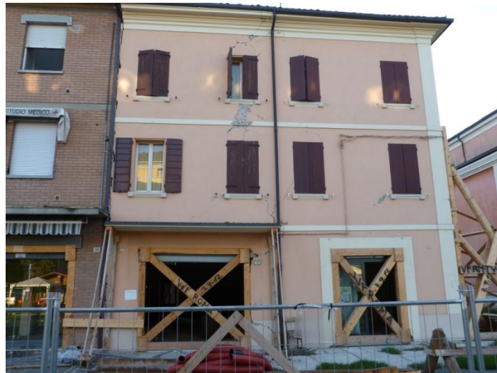
Fabbricato inagibile (Rovereto)
